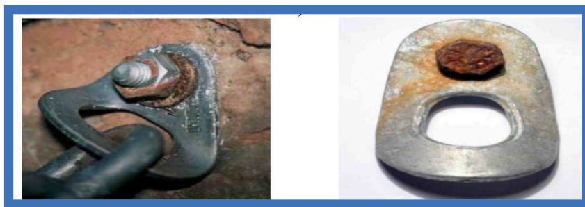
4.51. ábra. Rozsdásodó szénacél anyák és alátétek korrózióálló acélfülön
