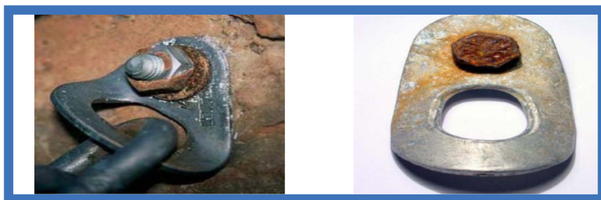
4.51. ábra. Rozsdásodó szénacél anyák és alátétek korrózióálló acélfülön
